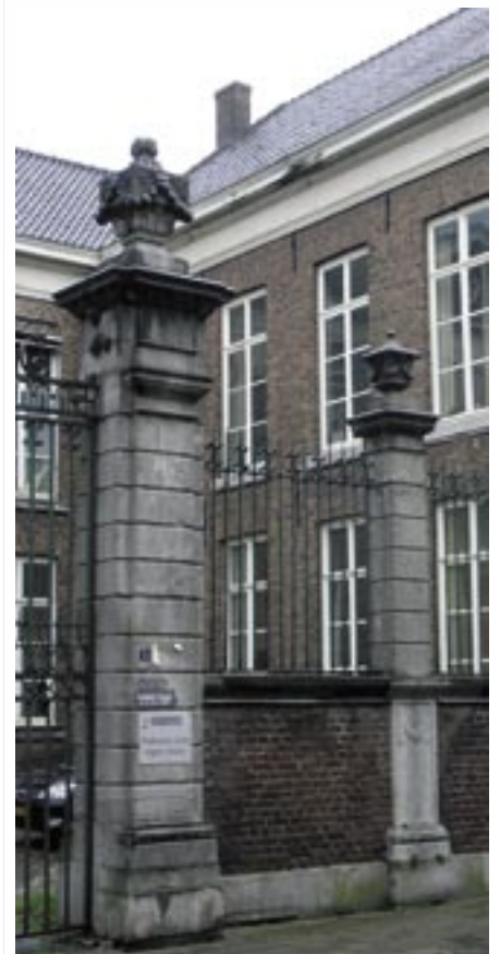
Voormalig Bisschoppelijk Paleis en Gerechtsgebouw met lekkende/kapotte dakgoot.
