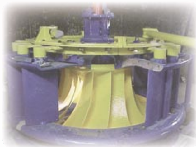
De turbine van de ECI-centrale Foto Waterschap Roer en Maas
