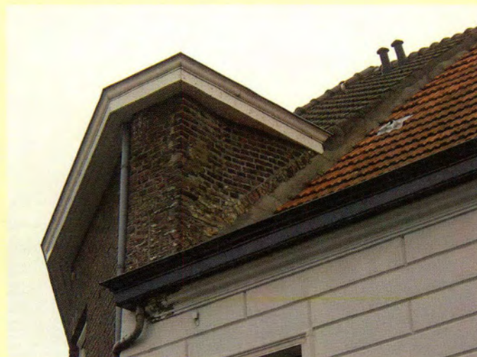
De kromming van de muur (buiten).
